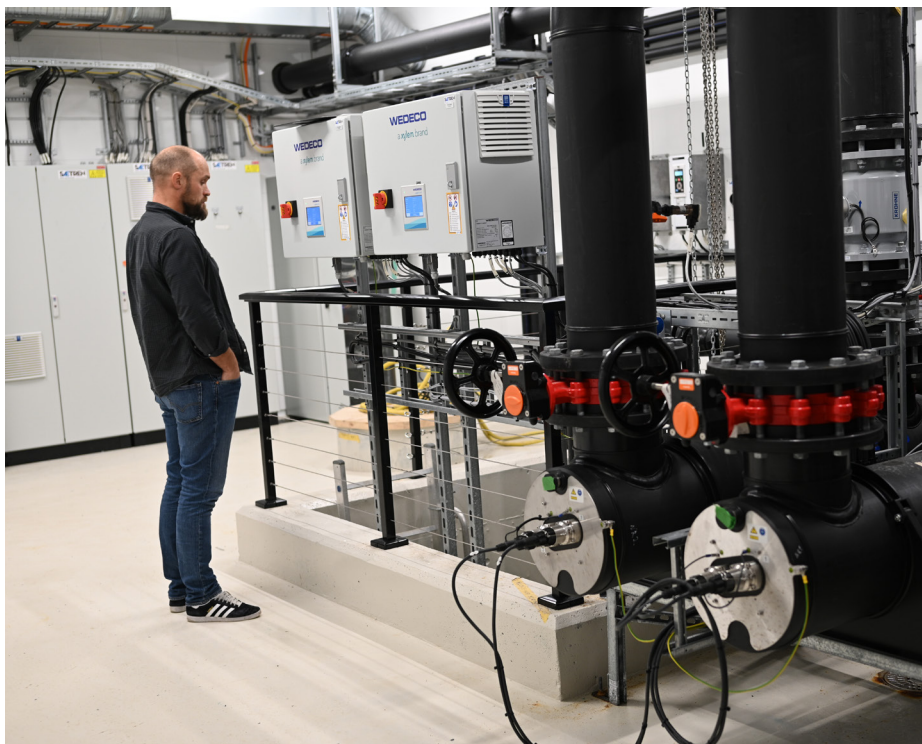
Teknisk sjef Yngve Hjertenes har jobbet i mange år ved ILAB og RAS-lab i Bergen. Her ved vanninntaket til den første tanken. Foto: Pål Mugaas Jensen
